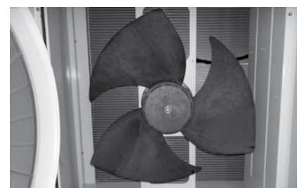
Kuva 6: Puhaltimen siipien asento
